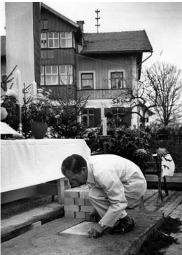
Bauführer Riegler legt die Kassette ein
